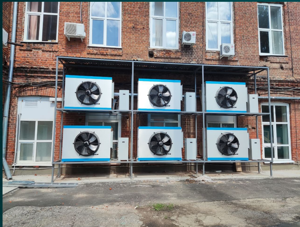
Внешние блоки, установленные на объекте
